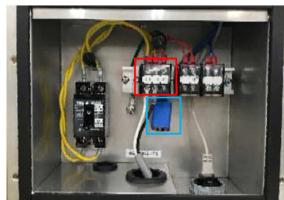
電源線 通信線(LAN) ※延長アダプタに接続
